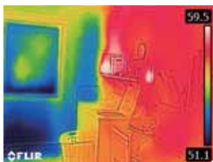
断熱不良の外壁
